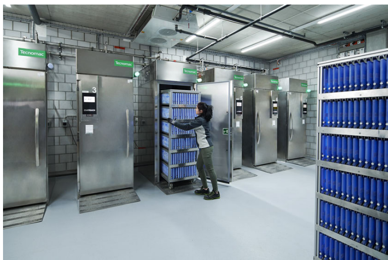
↑ Innovative Kühltechnik bei Galexis: Shock-Freezer
