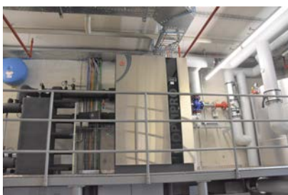
↑ Wärmepumpe bei Alloga in Burgdorf.
