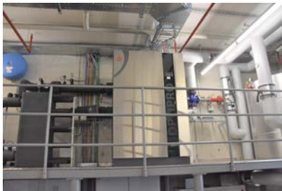
↑ Wärmepumpe bei Alloga in Burgdorf.
