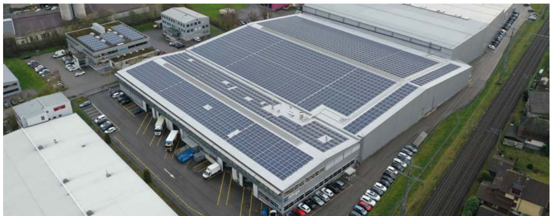
↑ Fotovoltaikanlage auf dem Dach von Alloga in Burgdorf.
